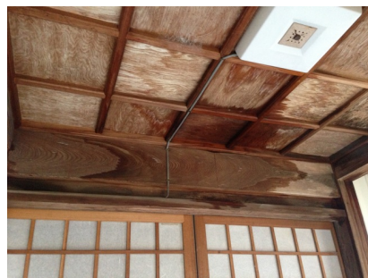
式台の雨漏り ←
