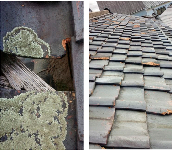
修理前の離れの屋根の状況 一部は穴が開いています。
