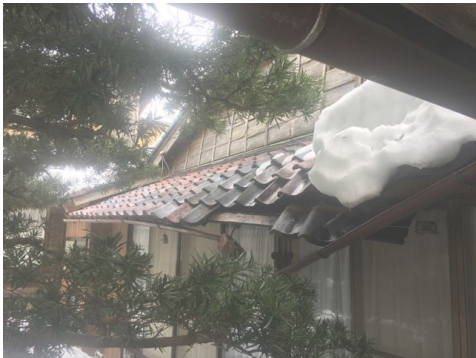
下屋が崩れてしまいました
