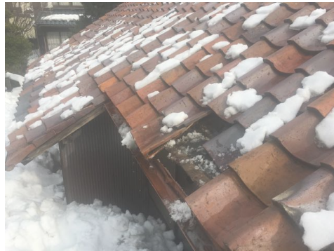
本堂の裏の屋根瓦が落ちました
